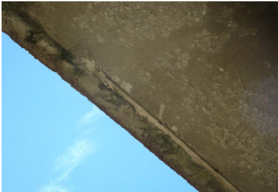
Foto 30 – Detalhe pingadeiras obstruídas por cantoneira de madeira
