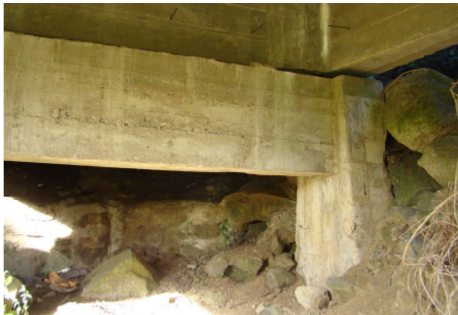
Foto 06 – Detalhe fraturas – Apoio P1
