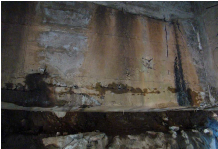
Foto 20 – Detalhe das fraturas na transversina de entrada – Lado Boa Vista
