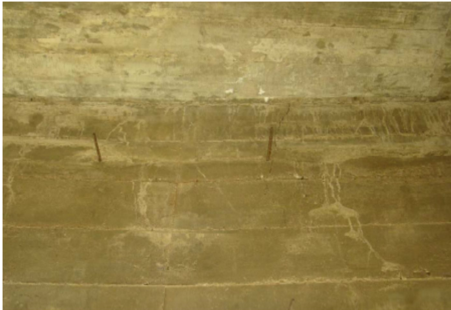
Foto 13 – Detalhe trincas entre apoio P1 e P2
