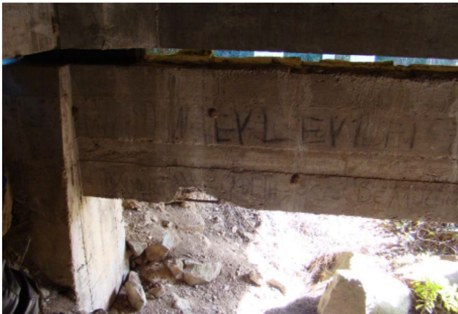
Foto 08 – Detalhe armadura exposta na travessa do Apoio P1
