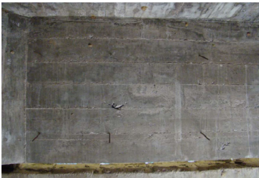
Foto 21 – Detalhe trincas na transversina de apoio – Apoio P1
