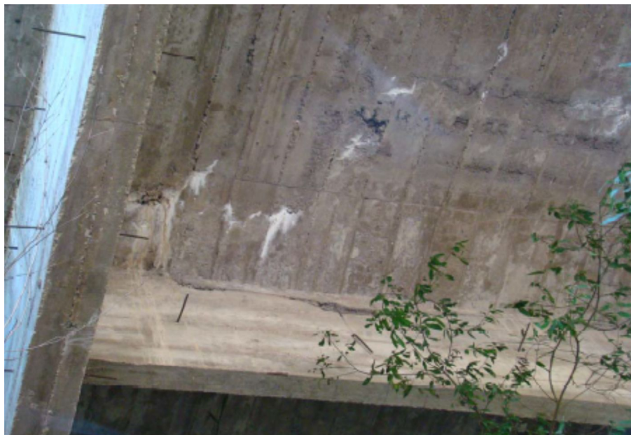
Foto 23 – Falha de concretagem – Vão P3 e P4
