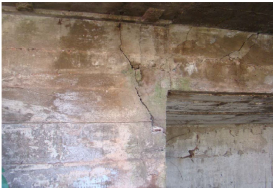
Foto 25 – Detalhe fratura na Ala esquerda – Lado Santana da Boa Vista
