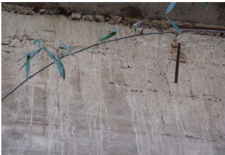
Foto 14 – Detalhe trincas apoio P4
