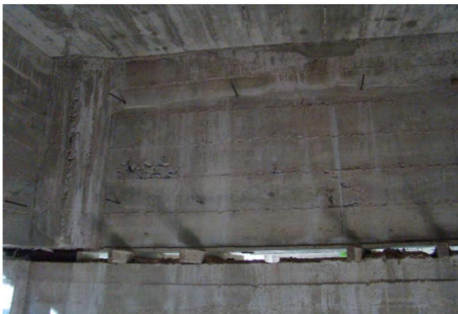
Foto 22 – Detalhe trincas na transversina de apoio – Apoio P4
