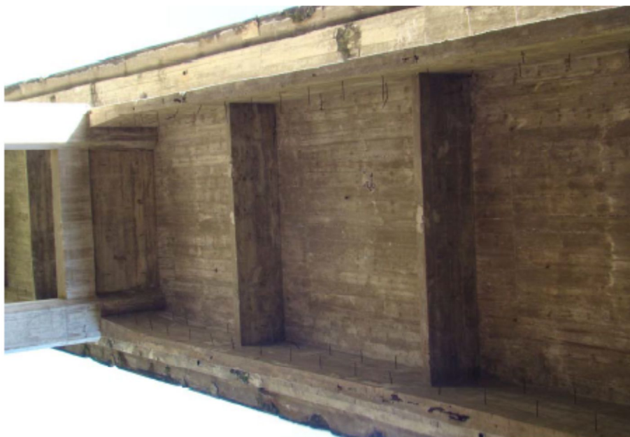
Foto 24 – Vista inferior lajes
