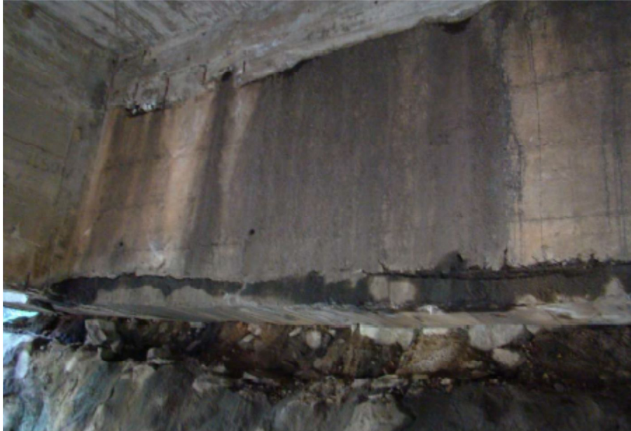
Foto 34 – Umidade com a percolação de água- transversinas de entrada
