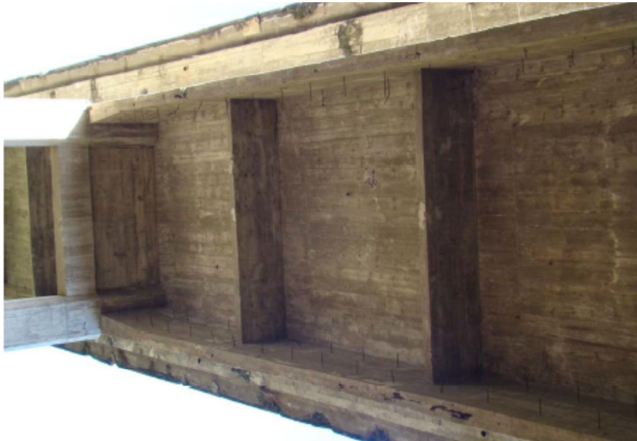
Foto 15 – Detalhe falha de concretagem nas longarinas
