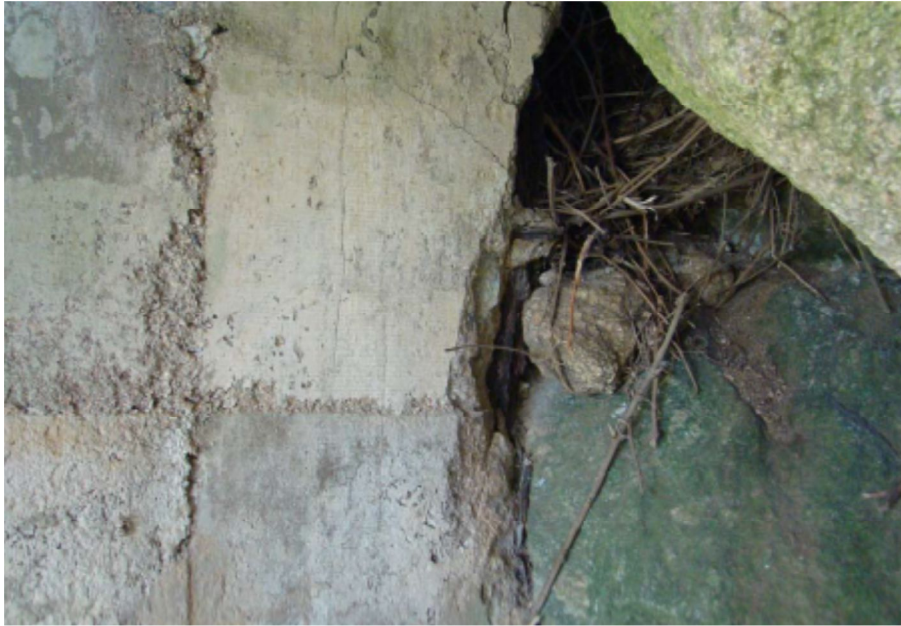
Foto 07 – Detalhe fraturas – Apoio P1
