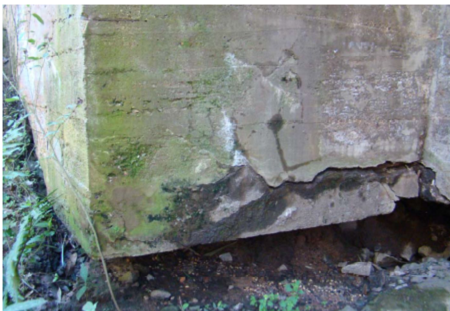
Foto 26 – Detalhe fratura na Ala esquerda – Lado Santana da Boa Vista
