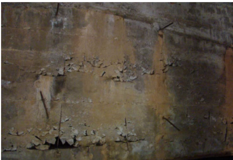
Foto 18 – Detalhe trincas na transversina de entrada – Lado Pelotas
