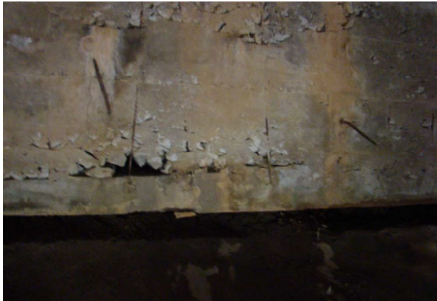
Foto 17 – Detalhe falha de concretagem na transversina de entrada – Lado Pelotas
