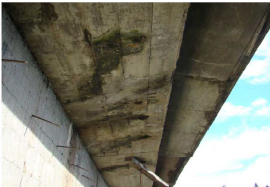
Foto 29 – Detalhe falha de concretagem e umidade nos balanços
