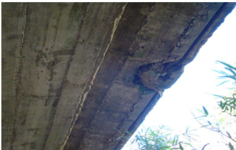
Foto 31 – Detalhe pingadeiras obstruídas por substituição inadequada dos guarda corpos
